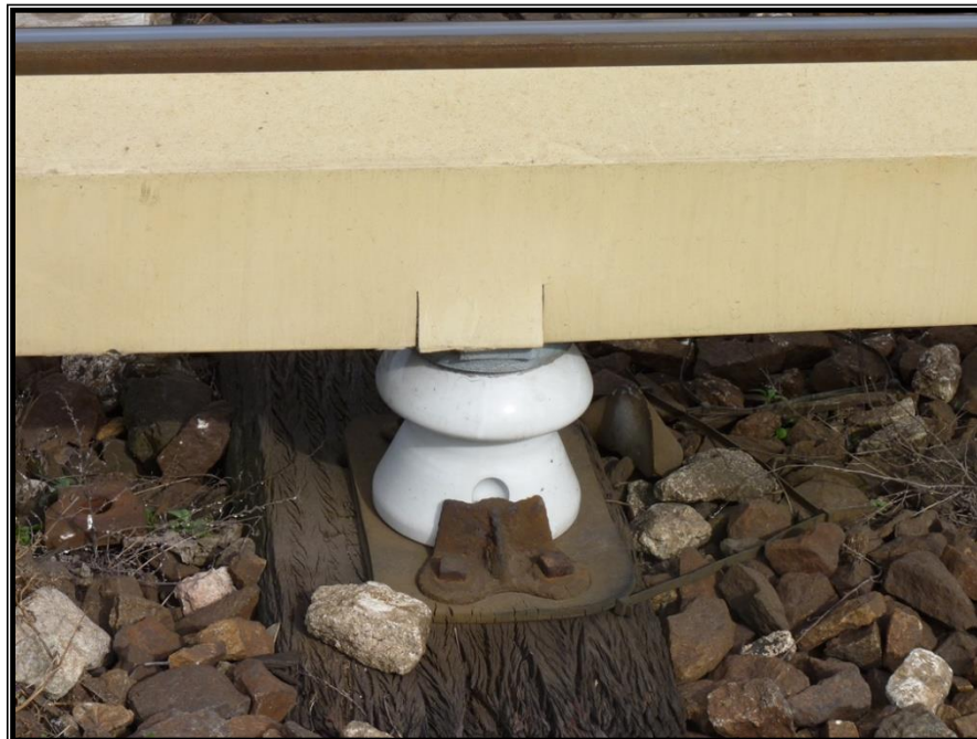
Foto 6. Aislador soporte instalado en durmiente de madera
