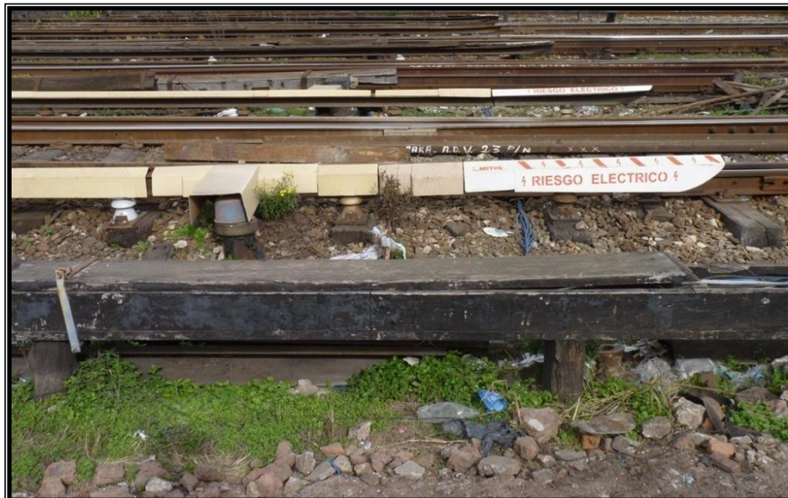
Foto 4. Tramo con aislador de soporte, acometida de cables desde subestación y rampa
