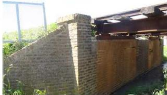
Alcantarilla Km 30,158 a Renovar.
