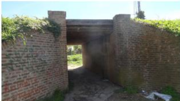
Alcantarilla Km 28,836 a Renovar.
